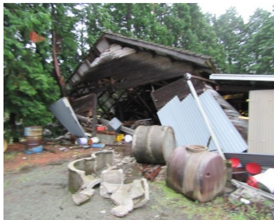
被災した農具小屋 (杉の木の支えで何とか倒壊を免れた)
